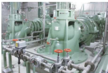
雨水ポンプNo.1、No.2
