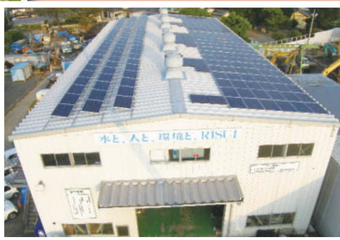
自社植木支店工場 (56.55kWシステム)
