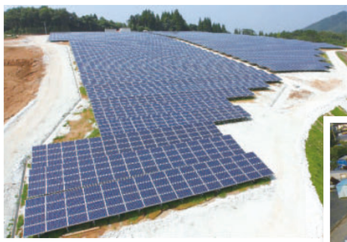
甲佐町:クリーンエネルギー熊本 (2.15MWシステム)
