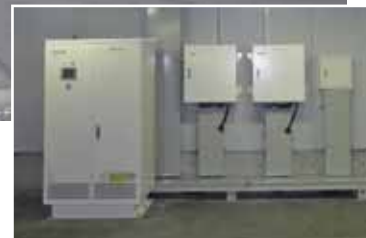
▲パークドーム内電気室の蓄電池システム
